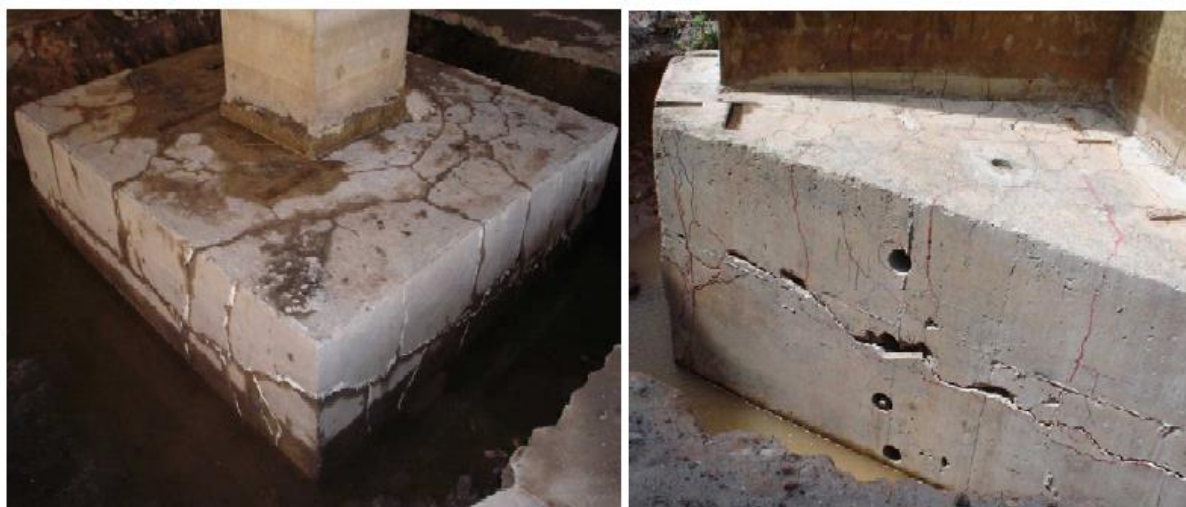
FIGURA 2.6 - FISSURAÇÃO EM FUNDAÇÕES AFETADOS PELA RAA.
