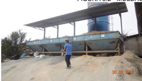
(a) Central de concreto.
