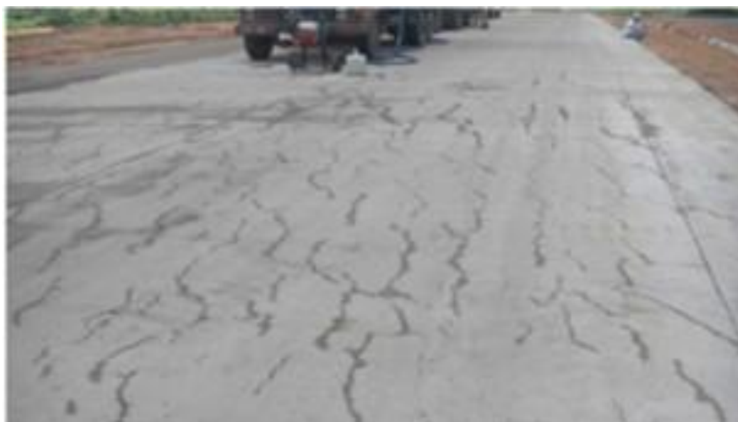
Figura 1: Fissuras no pavimento rígido do lote 05, da BR-101/NE.
