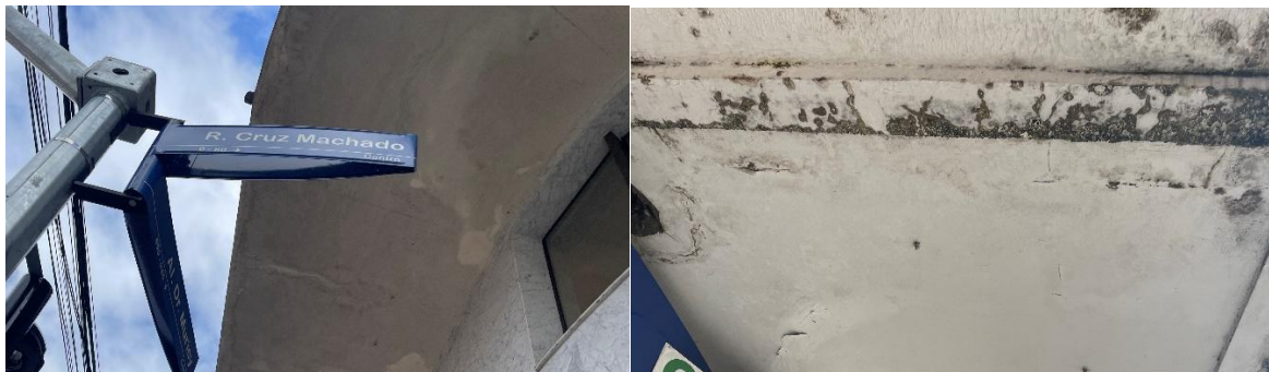
Figura 6: Exemplo de marquise em condição intermediária (esq.) e em condição crítica (dir.)
