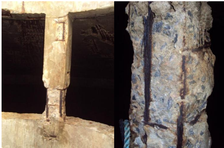
Figura 3: Corrosão das armaduras dos pilares de sustentação da laje de cobertura do REL do SAA da cidade de Carpina denominado R-2
