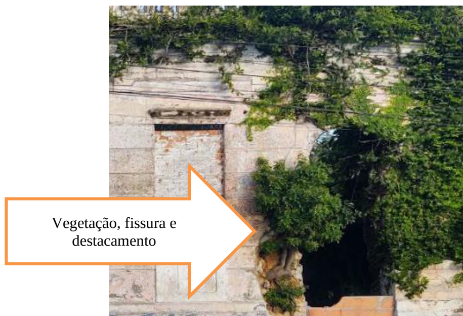
Figura 2: Foto de fachada com elevado nível de degradação
