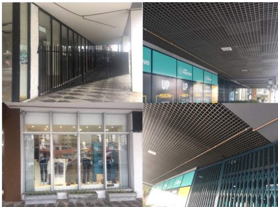
FIGURA 12 - Chuveiros instalados no teto das galerias
