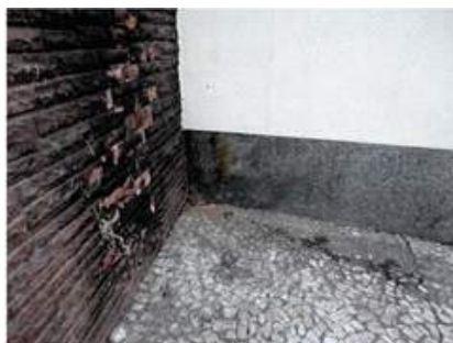
Figura 9e Detalhe figura 9d
