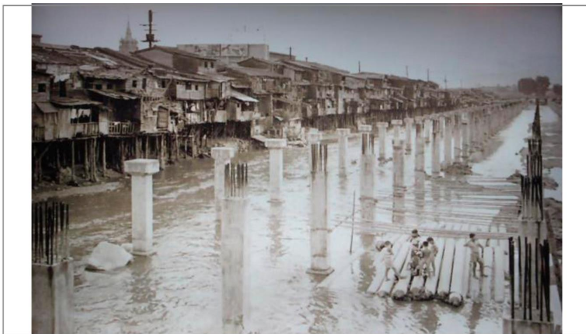
Figura 37 – Construção dos pilares que sustentariam a via sobre o rio Cheonggyecheon – década de 1950.
