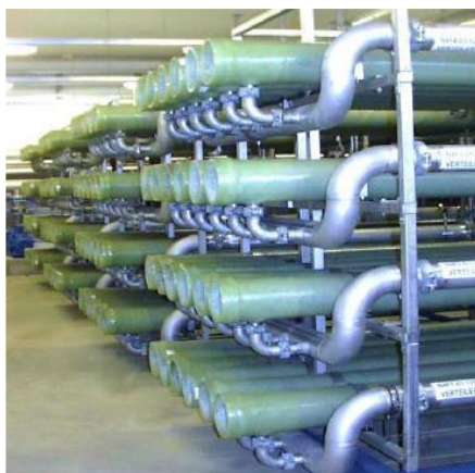
Figura 4 – Instalações do sistema de nanofiltração da cidade de Eltmann Fonte: Adaptado de WEHRLE (2017)
