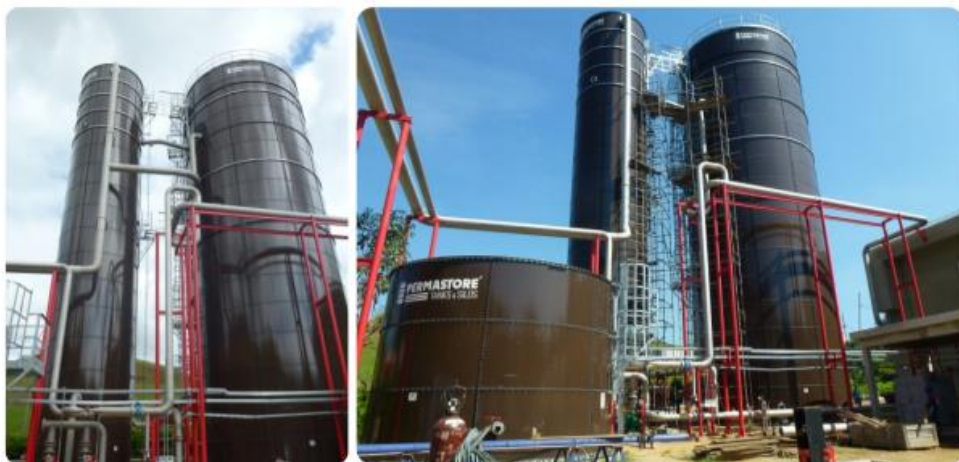
Figura 8 – Instalações do sistema de tratamento da cervejaria Fonte: Adaptado de WEHRLE (2017)
