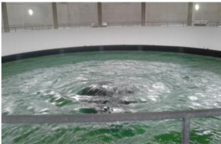
Figura 5 - Entrada água na ETA Fonte: Arquivo fotográfico PPGMAUI turma 2016
