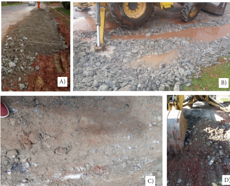
FIGURA 5 – EXECUÇÃO DE TRECHO EXPERIMENTAL COM AGREGADO RECICLADO DE CONCRETO (ARC) EM BASE DE PAVIMENTOS: A) MATERIAL SENDO APLICADO NA PISTA; B) MATERIAL ENCHARCADO E CONTAMINADO COM TERRA; C) DEFORMAÇÕES E TRINCAS APÓS COMPACTAÇÃO E ESTABILIDADE COMPROMETIDA; D) REMOÇÃO DO MATERIAL. CURITIBA (25/04/16)
